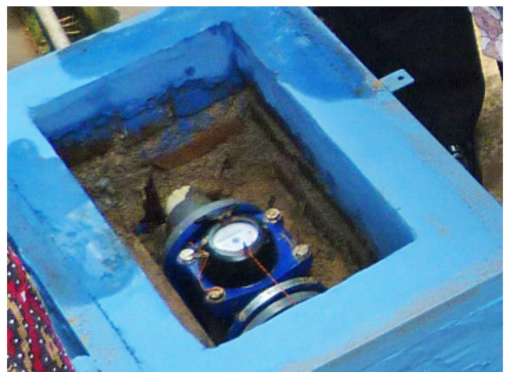
Sebuah Master Meter yang baru terpasang di Desa Ketapang, Kota Sibolga, Sumatera Utara.
